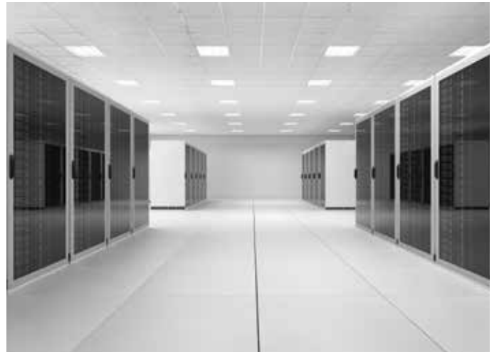
Centro de Proceso de datos - Data Centers
