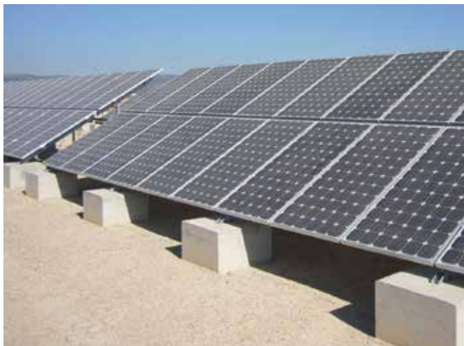
Plantas Fotovoltaicas - Parques Fotovoltaicos
